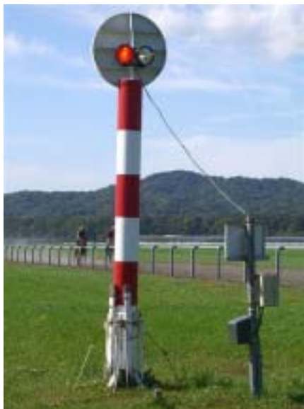
シグナルライトの点灯状況
